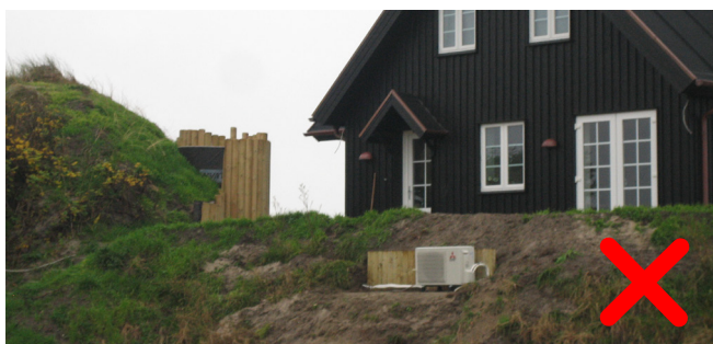
Varmepumpe ikke indbygget eller indpakket.
