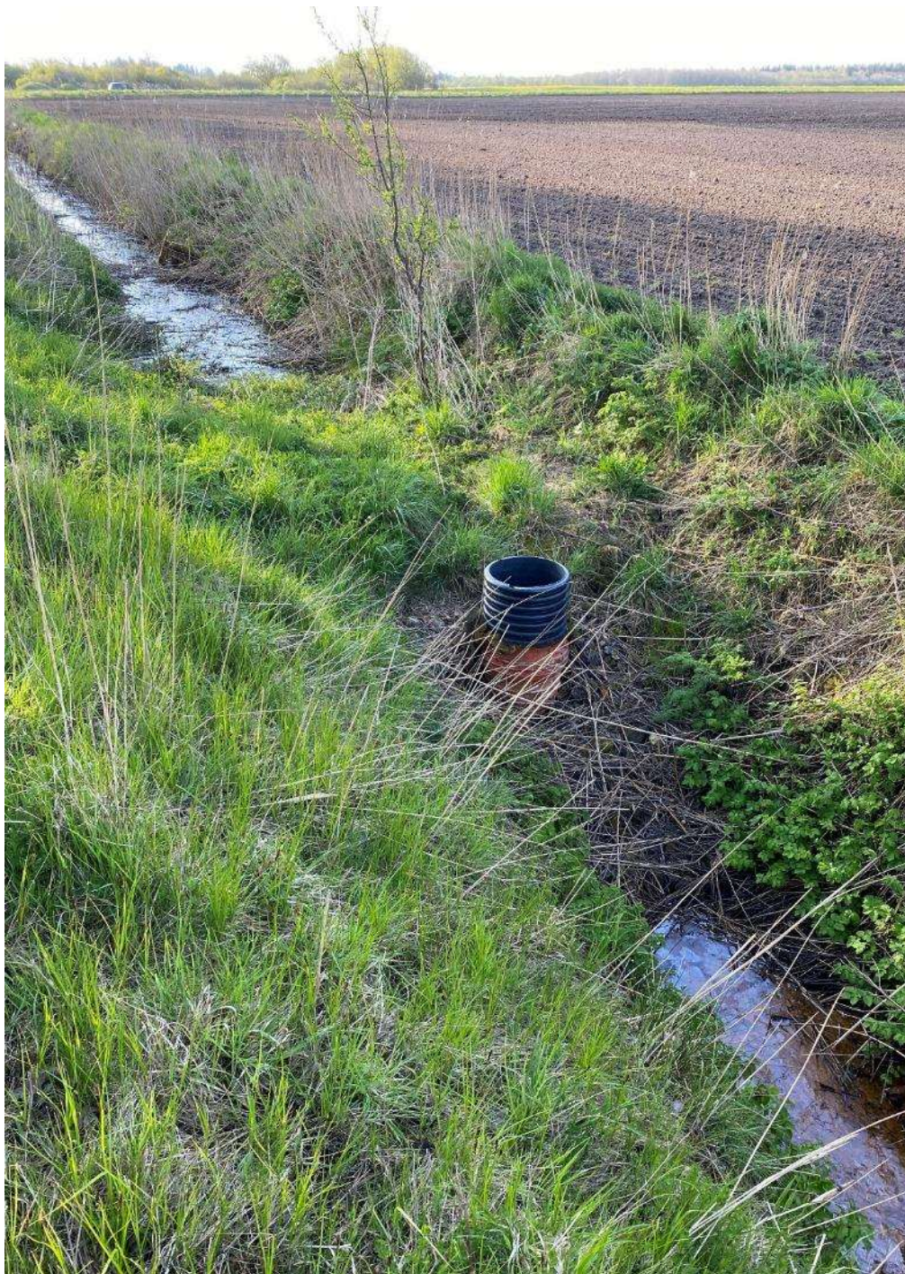
Figur 65. Position 7. Her er drængrøft stemmet op og der er etableret et overløb for at lede vandet ind i minivådområdet benævnt vandhul C (Figur 32). Vandet er stærkt okkerpåvirket i den nedre del af vandløbet, der ikke er opstemmet, mens vandkvaliteten er bedre oven for opstemningen.
