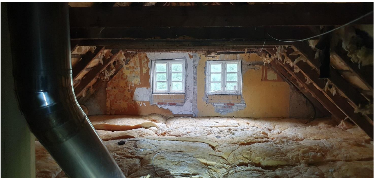
Isolerede lofter under de nye tage på Toftegårdsvej 131 viste ingen visuelle tegn på flagermusaktivitet.
