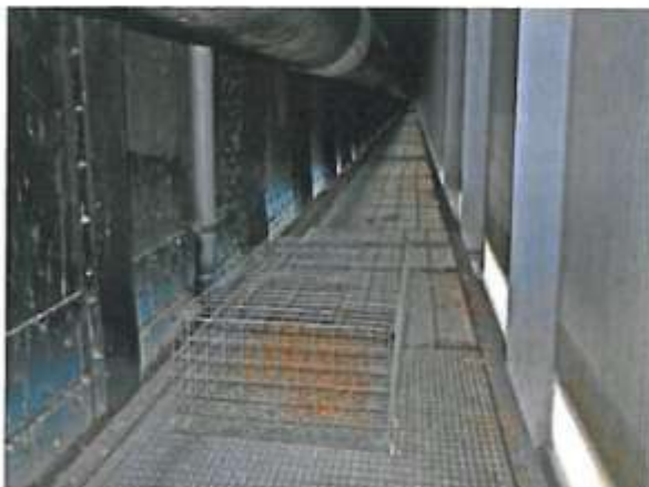
Enkelte steder indfanges duer v.h.a. fælder. Her ses en duefælde under Limfjordsbroen
