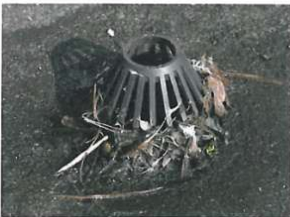
På flade tage kan redemateriale og føderester skabe problemer i form af tilstoppede afløb og udluftningskanaler
